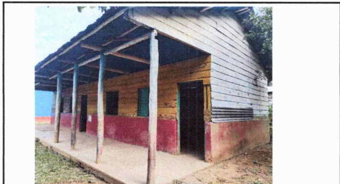
Foto 1: Se observa el deterioro de las paredes y columnas que sostienen el techo de las aulas.
